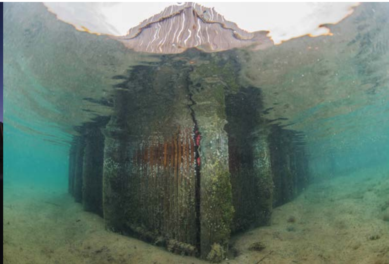
Las "paranzas", que pueden estar ubicadas a lo largo de la "travesía", son unas estructuras cuadradas, formadas por cañas, hábilmente entrelazadas con cuerdas, clavadas sobre el mismo suelo del canal y reforzadas por gruesas estacas.
